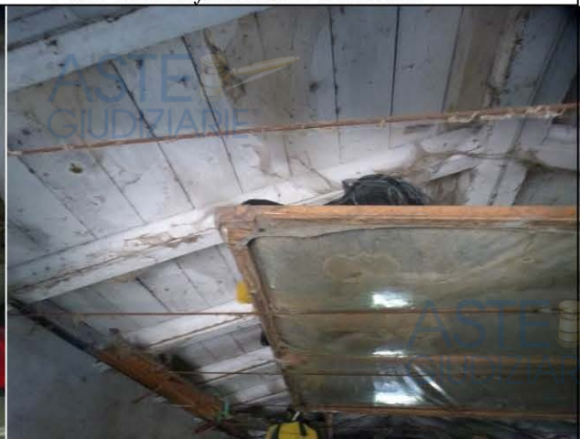
Vista interna attrezzaia
