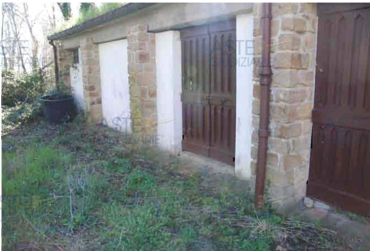
Fot. 19-20 Vista del proservizio. Dettaglio del distacco tra cornicione e tamponamento esterno.
