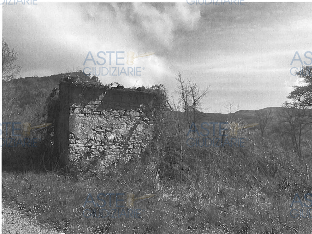
1) Lato Sud – Fabbricato Diruto immobile A)
