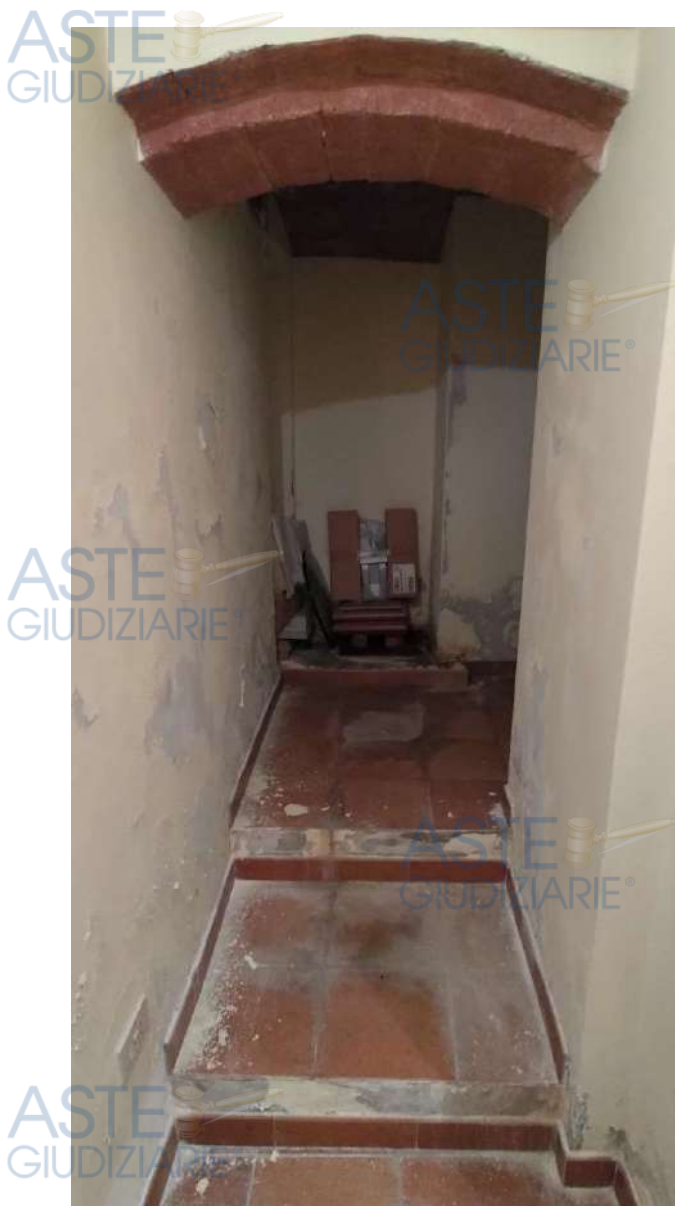
Foto 11 disimpegno particolare umidità di risalita
