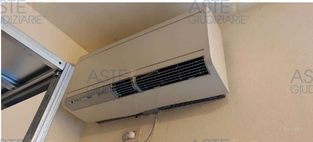
Foto 9 – particolare ventilconvettore a parete
