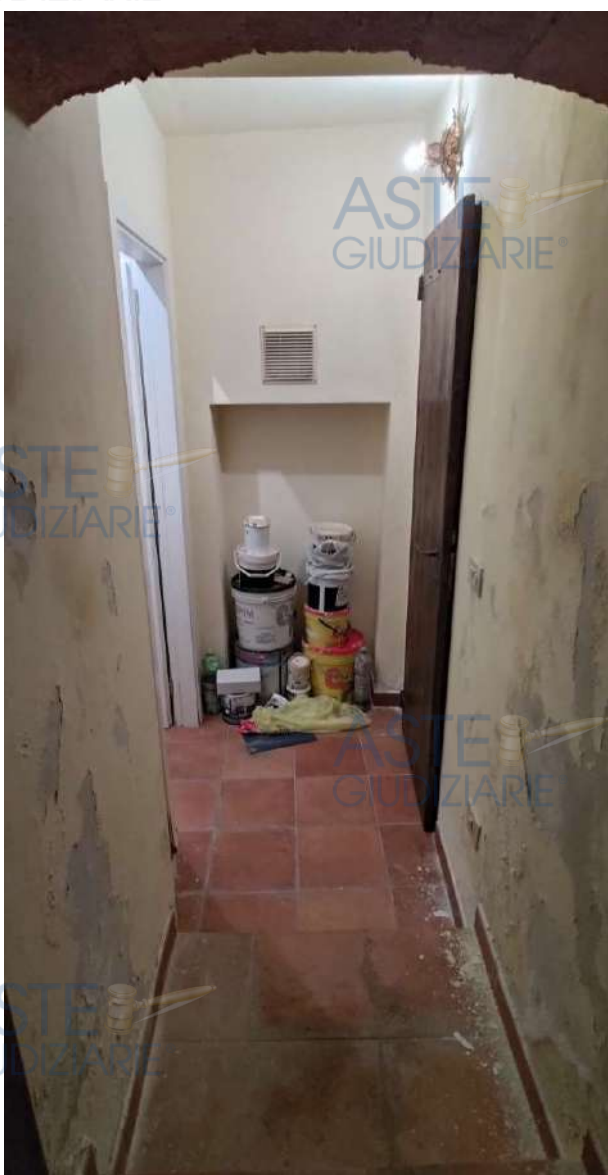
Foto 10 – disimpegno particolare umidità di risalita
