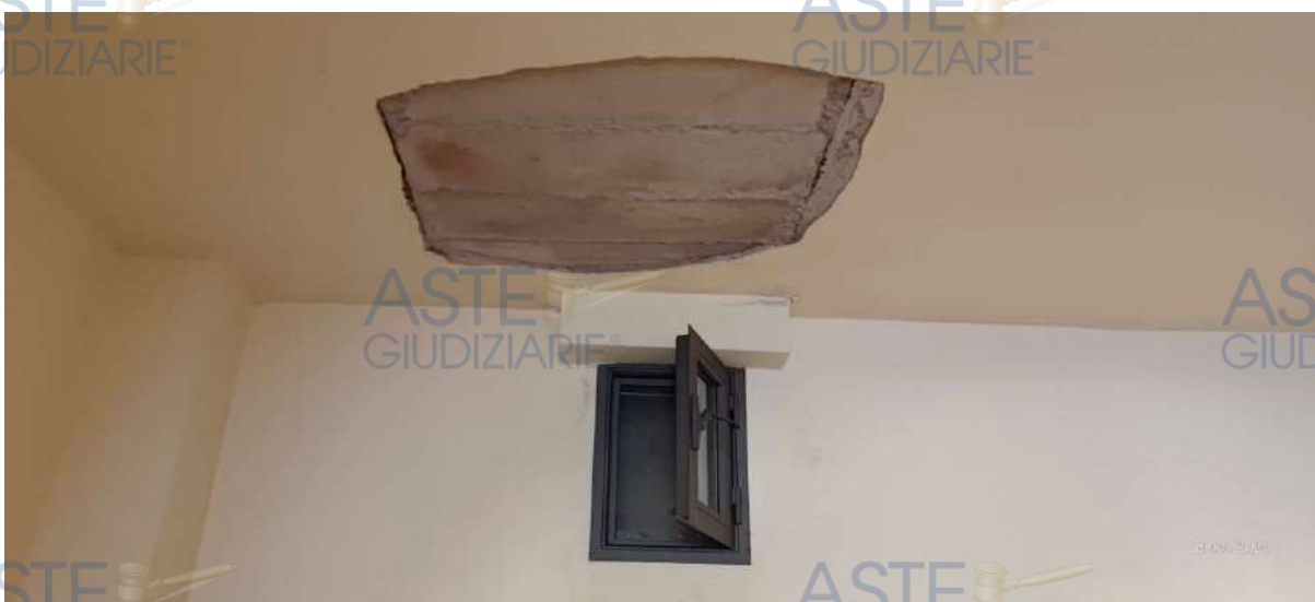
Foto 8 – particolare rovina intonaco solaio
