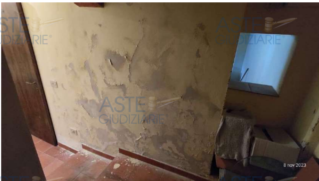
Foto 16 - particolare disimpegno stato conservazione muro
