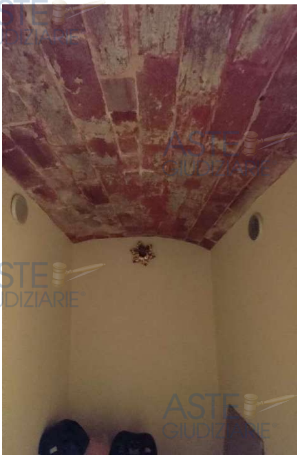
Foto 15 – ripostiglio particolare soffitto
