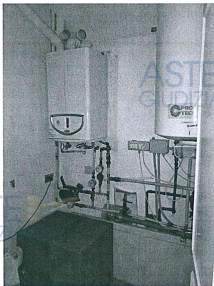
11- il locale caldaia
