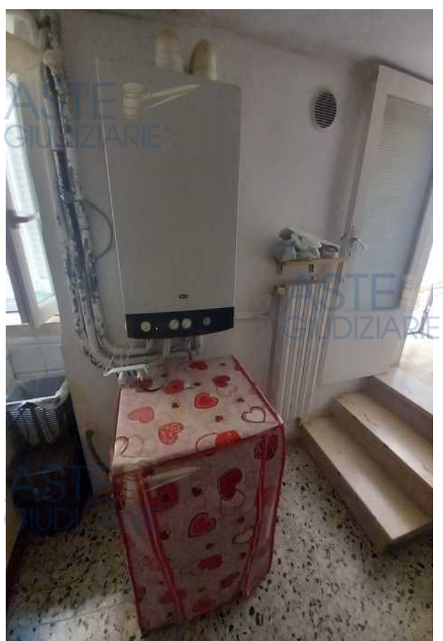
CALDAIA – RIP. PIANO TERRA
