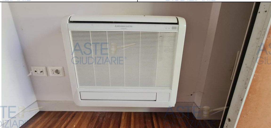
Sopra: i locali soggiorno e camere sono dotati di un ventilconvettore come terminali, unità interne, per la climatizzazione estiva ed invernale
