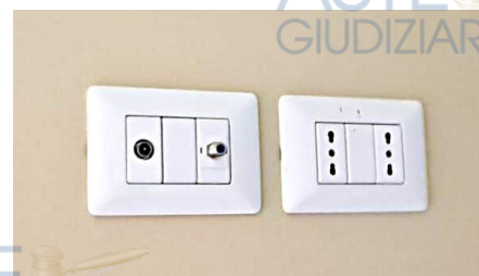
Sopra: Impianto antenna Tv e predisposizione tv satellitare
