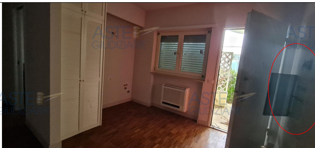
Comformazione e dotazione rappresentativa del locale Soggiorno dotato di angolo cottura ventilconvettori a destra quadro elettrico cassetta sicurezza
