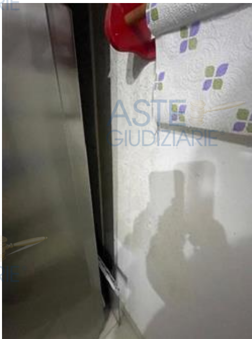
macchia di umidità in cucina
