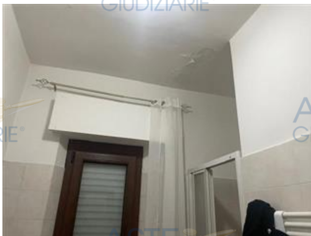
macchie su soffitto bagno
