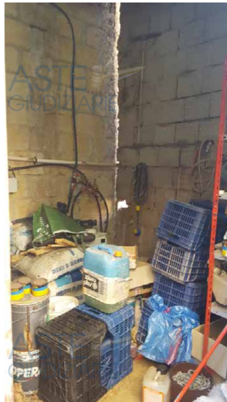
Foto N. 15: Parete in laterizio sconnessa del locale idrico da demolire Lotto L4
