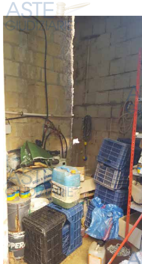
Foto N. 6: Parete in laterizio sconnessa del locale idrico da demolire Lotto L4
