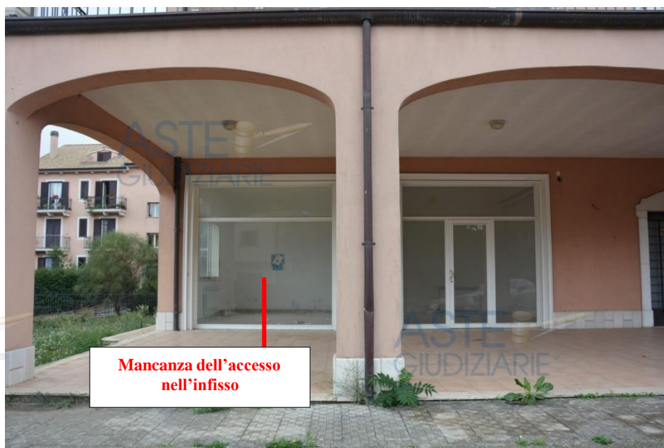
Foto 2. Difformità rilevante nel sub 36: mancanza del varco nell'infisso
