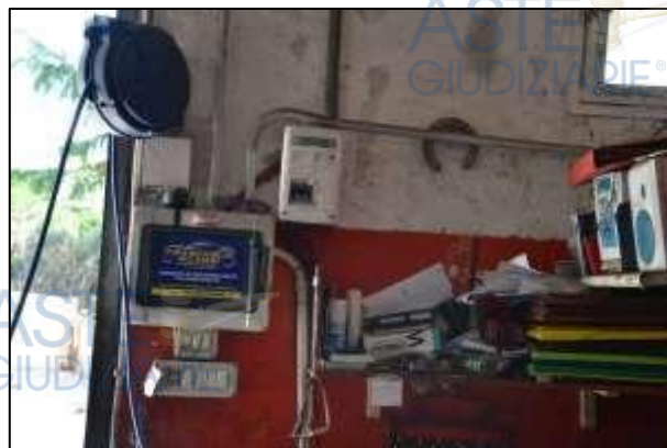
Figura 95 - Contatore linea elettrica BENE M
