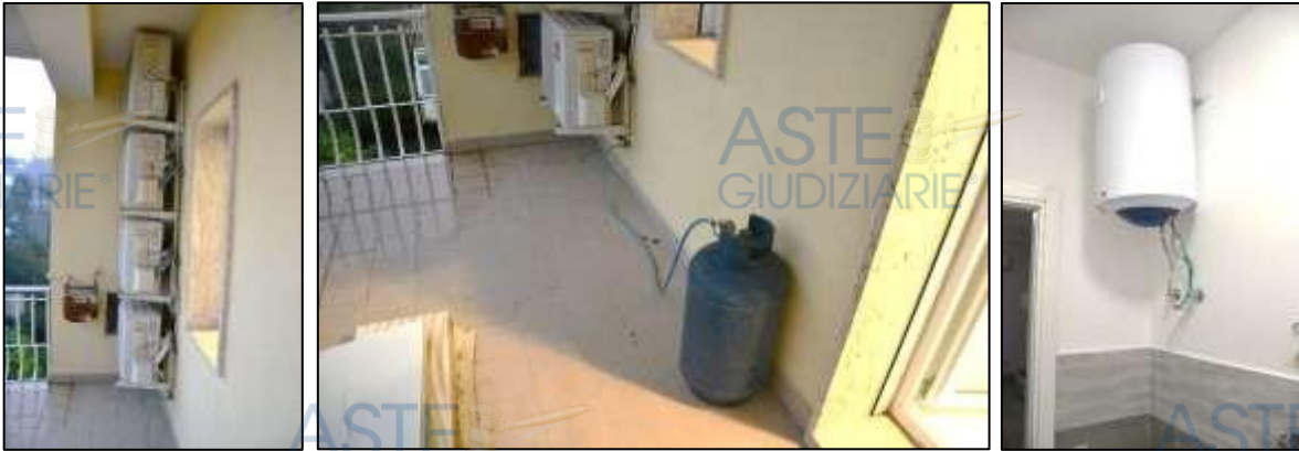
Figura 90 – Bombola gas cucina - Contatore acqua - Bollitore elettrico - BENE D
