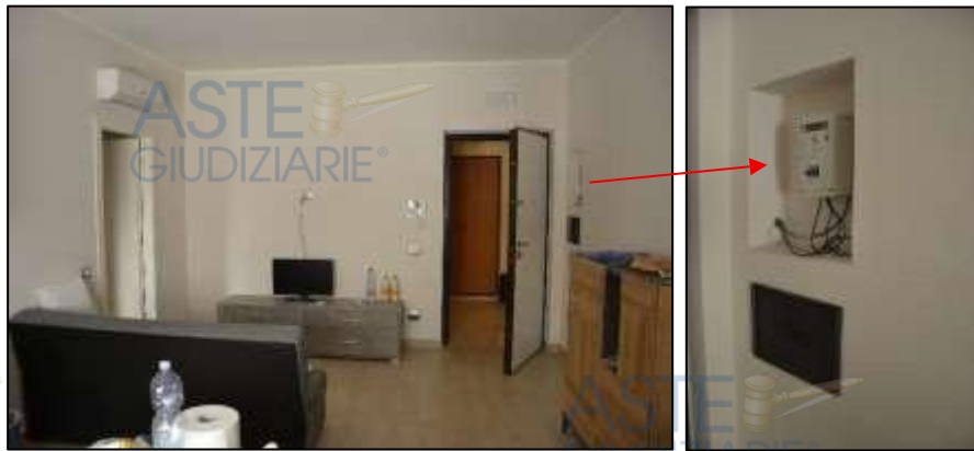
Figura 82 - Contatore linea elettrica comune ai BENI A – C – D
