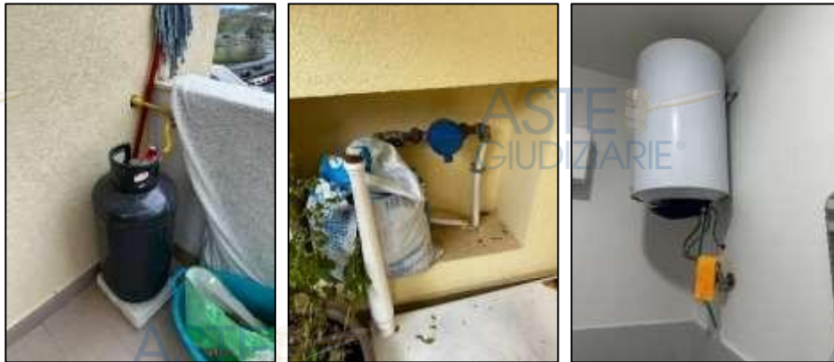
Figura 88 – Bombola gas cucina - Contatore acqua - Bollitore elettrico - BENE C
