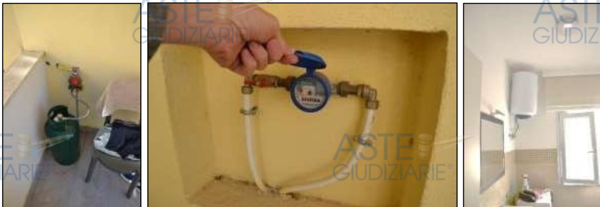
Figura 83 – Bombola gas cucina - Contatore acqua - Bollitore elettrico - BENE A
