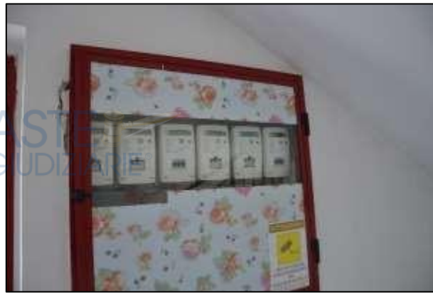
Figura 92 - Contatore linea elettrica BENE L
