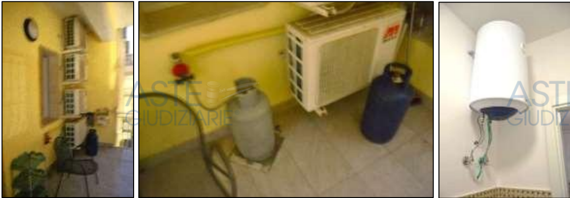
Figura 86 – Bombola gas cucina - Contatore acqua - Bollitore elettrico - BENE B
