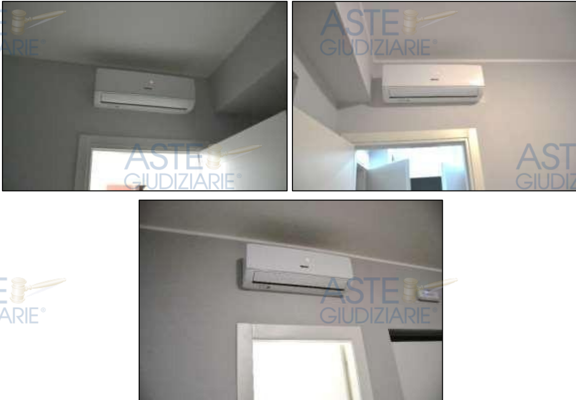
Figura 91 – Condizionatori BENE D
