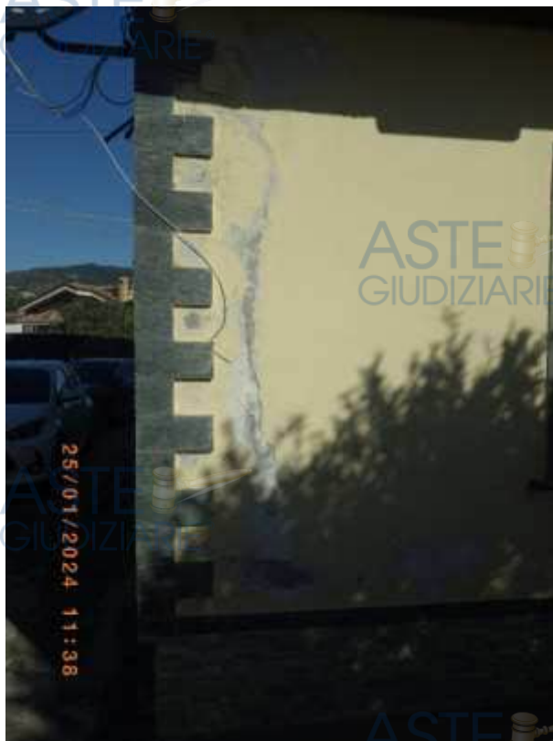
Foto 22. Particolar lesione su parete esterna
