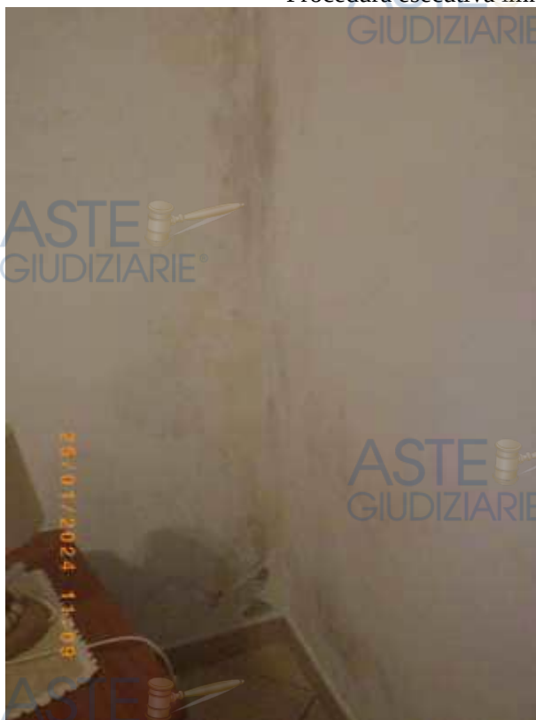
Foto 10. Particolare umidità spigolo Camera da letto matrimoniale
