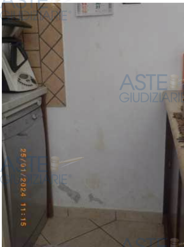
Foto 16. Paricolare_Cucina (umidità di risalita)
