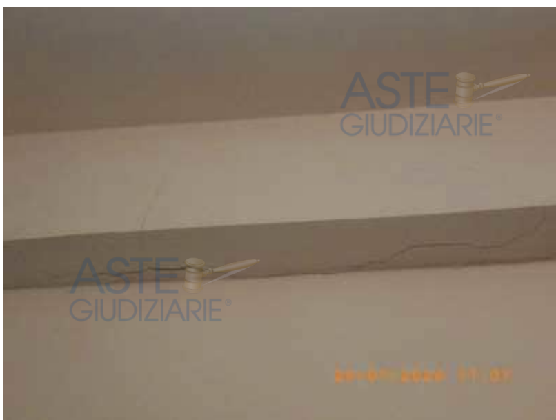
Foto 5. Particolare lesione trave Camera da letto singola
