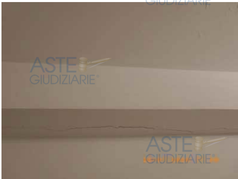
Foto 2. Particolare lesione trave bagno 1
