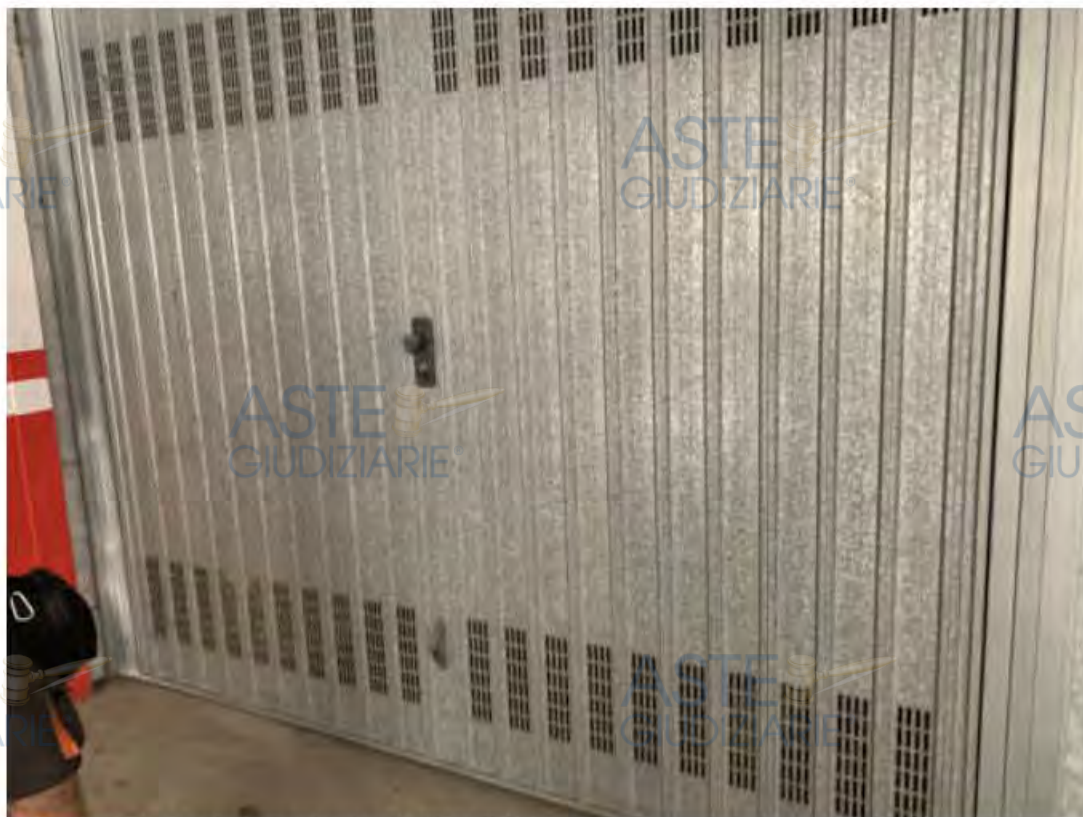
Foto N. 8: la porta basculante del box int 7
