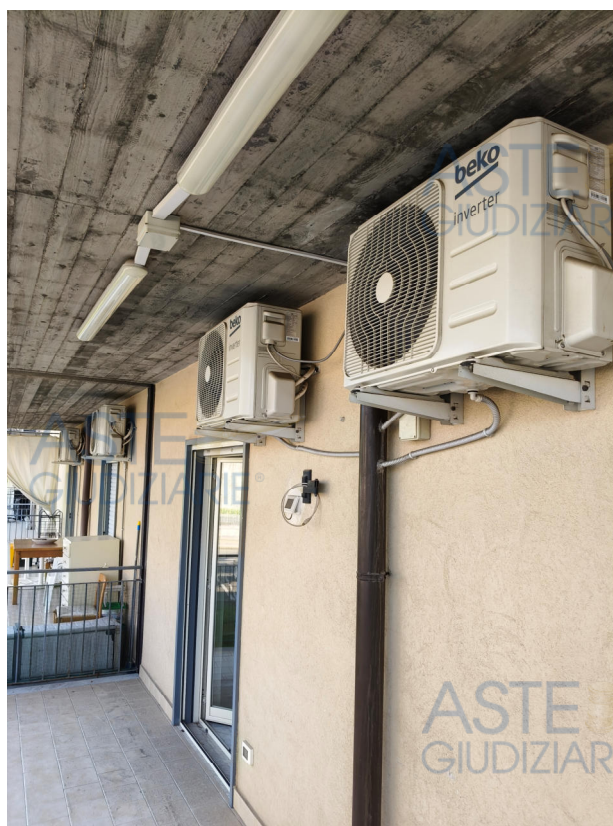
Figura 14- Visualizzazione dell'unità esterna di climatizzazione
