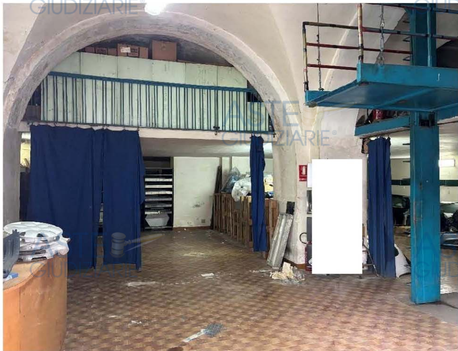
Immagine 14 – foto dell'interno della rimessa, si può notare il soppalco abusivo
