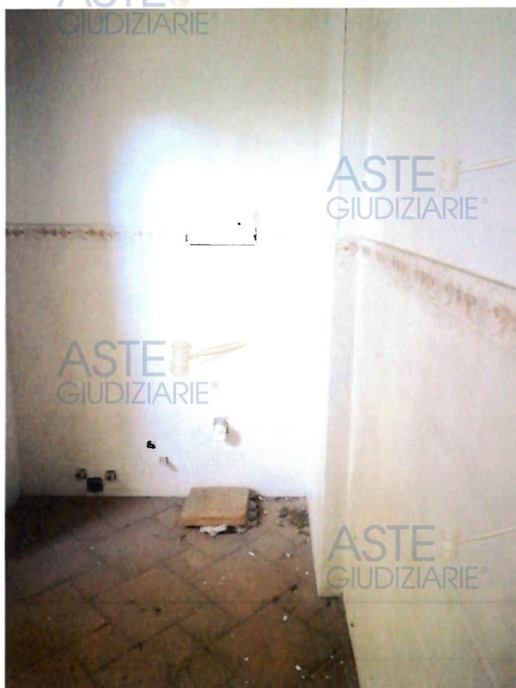
Foto n. 3- Visualizzazione del bagno a piano terra
