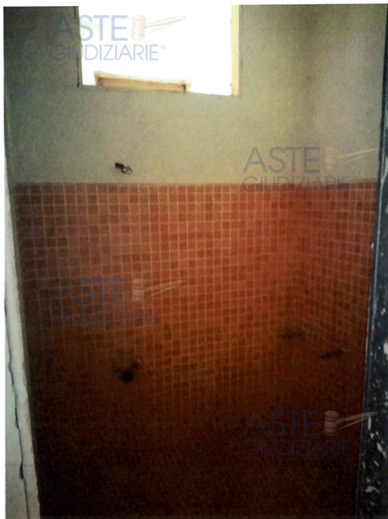
Foto n. 3- Visualizzazione del bagno a piano terra
