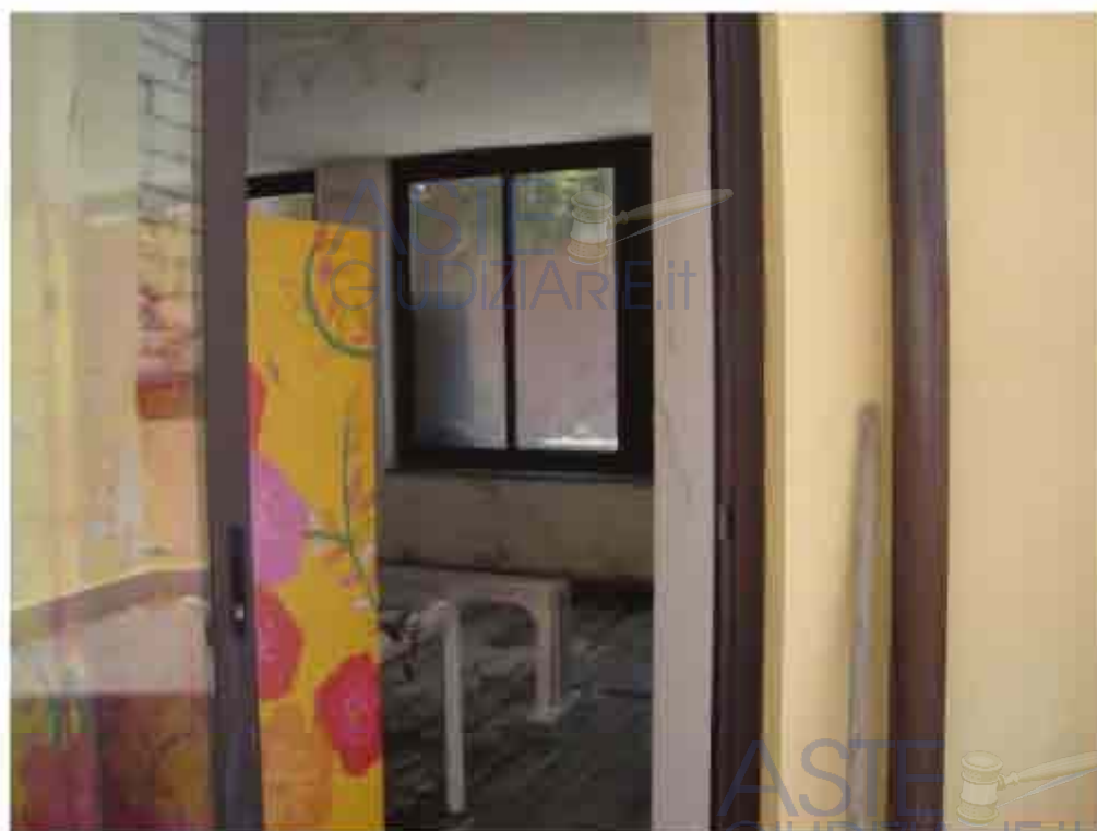
Foto 6 – Lotto 5 - Particolare "stato di degrado" pavimentazione
