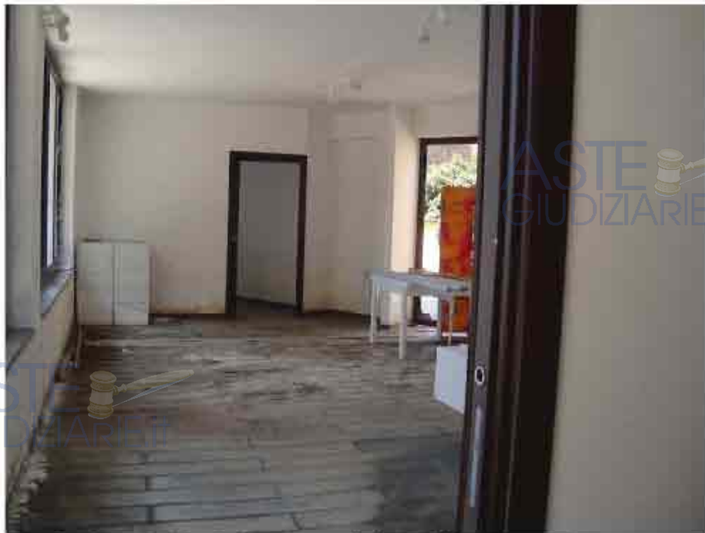
Foto 5 – Lotto 5 – Particolare "stato di degrado" pavimentazione garage
