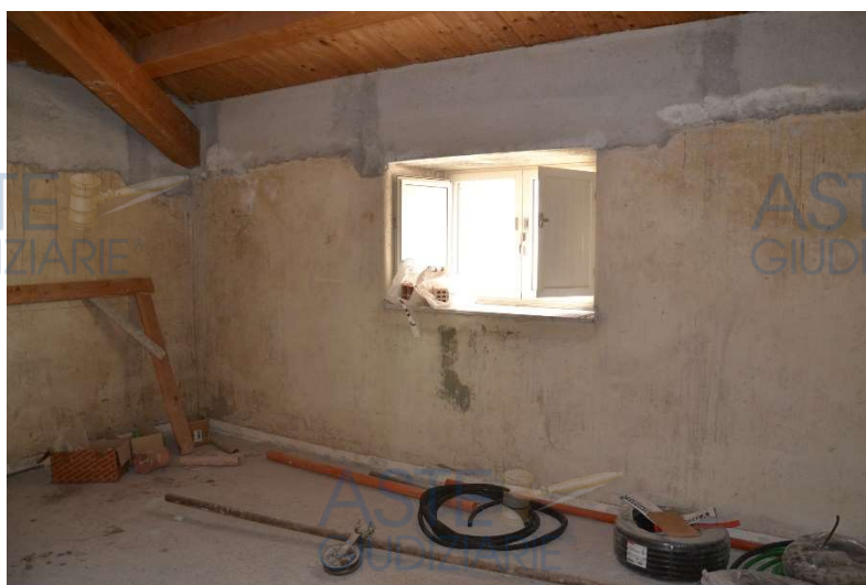
Vista Vano Nord-Ovest Sub 41
