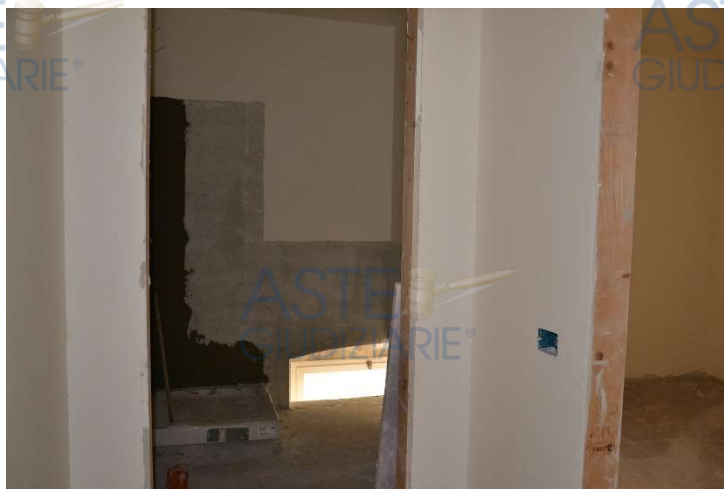
Vista interna sub 23
