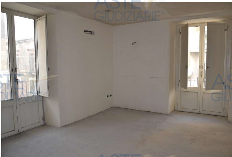
Vista interna sub 22
