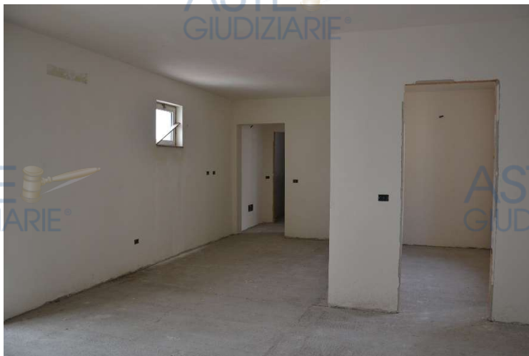
Vista interna sub 26
