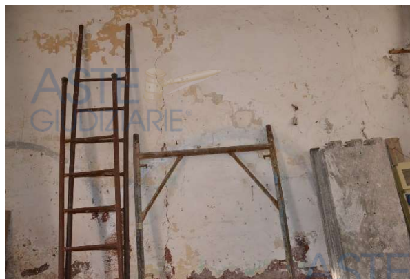
Vista interna SUB 43
