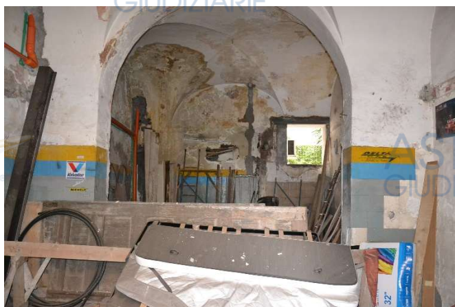
Vista interna SUB 47
