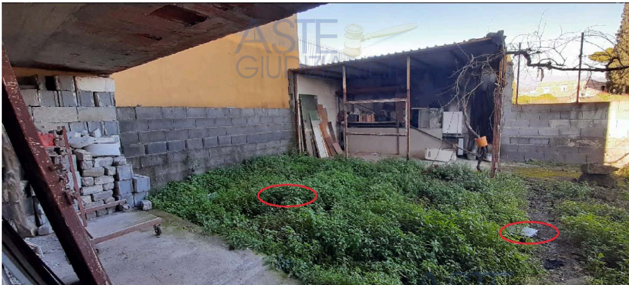
Sopra: Cortile nel quale insistono le fosse settiche.
