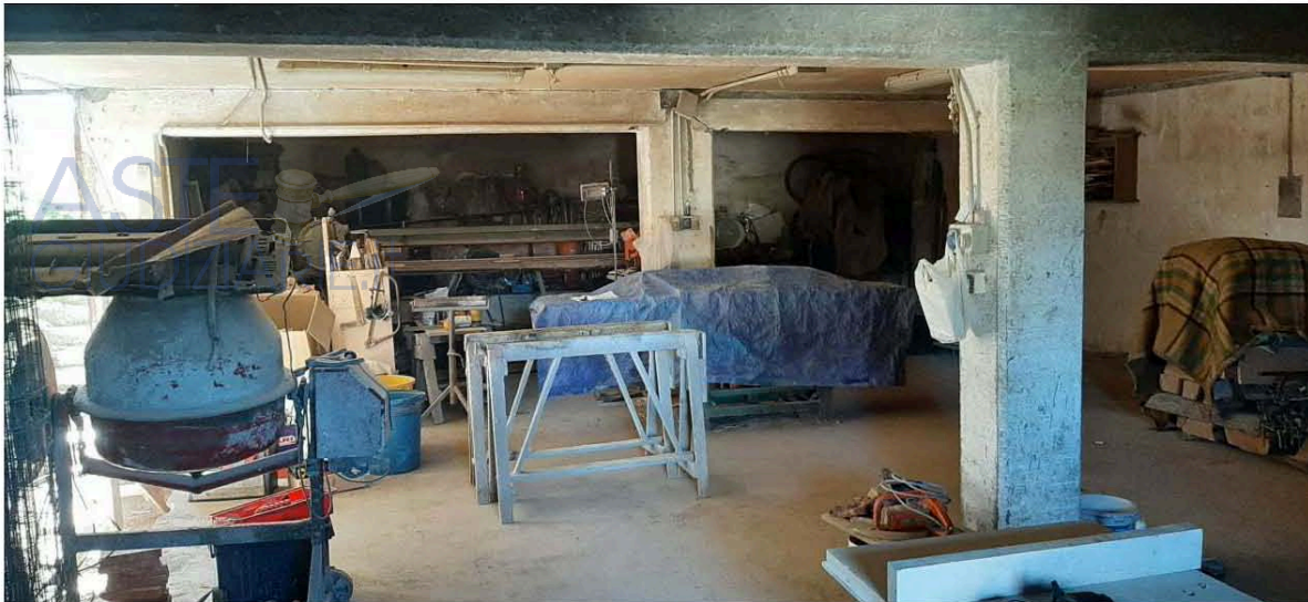
Sopra: Interno del magazzino e suo stato conservativo.
