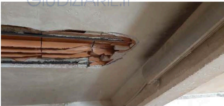
A Sinistra: distacco intonaco e conseguente rottura della pignatta su un punto del soffitto.
