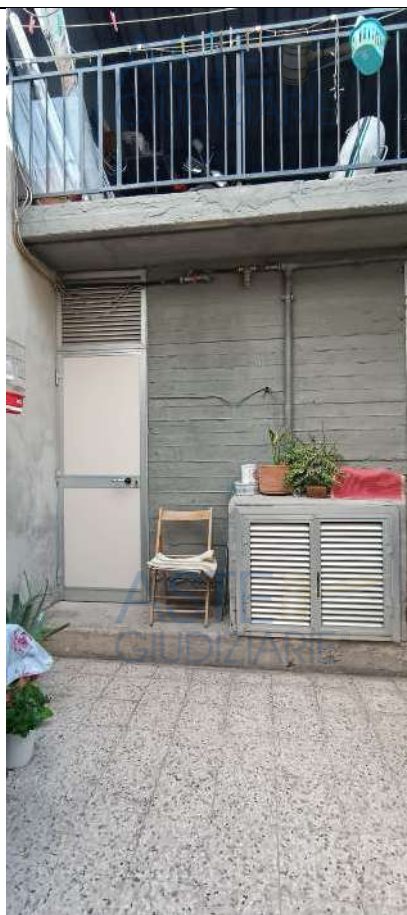
Foto 4 locale vasche e motore acqua potabile
