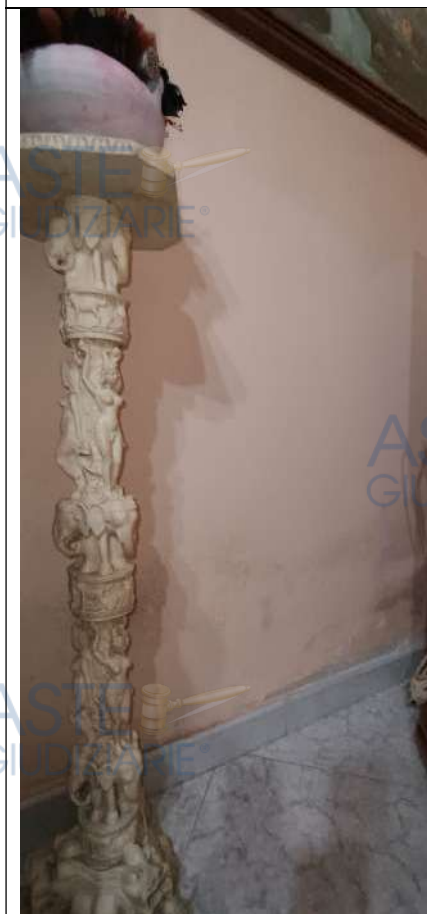
Foto 17 tracce di umido in salotto
