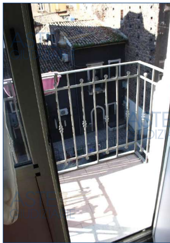
Foto 28 - Balcone su via Porta di Ferro
