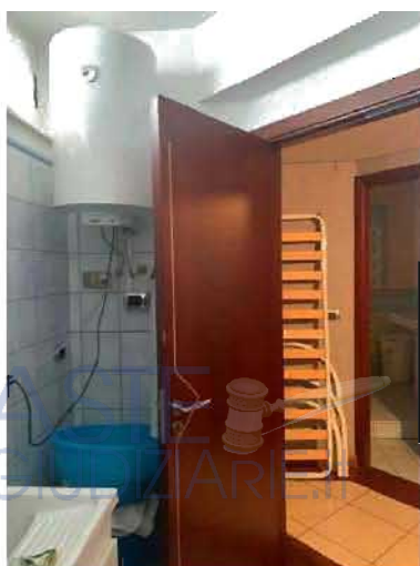
Dettaglio scaldabagno elettrico nella lavanderia
