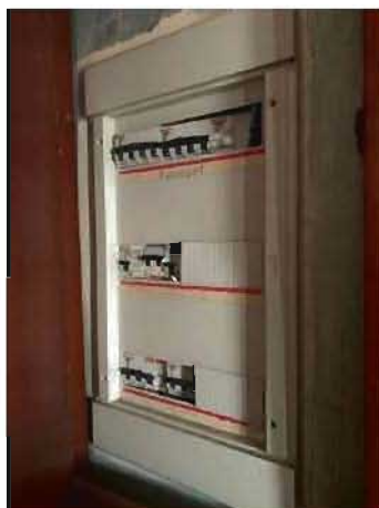
Dettaglio quadro elettrico
