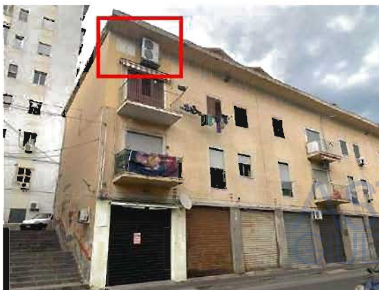
Vista dell'unità di climatizzazione esterna e del varco di ispezione
