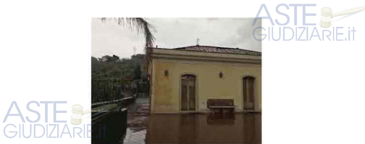
Patologie da umidità sul paramento esterno
