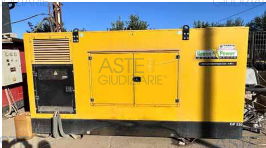
Foto 35: Gruppo Elettrogeno GREEN POWER - vista frontale.
