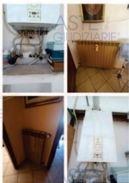
Impianto termico con caldaia a gas
