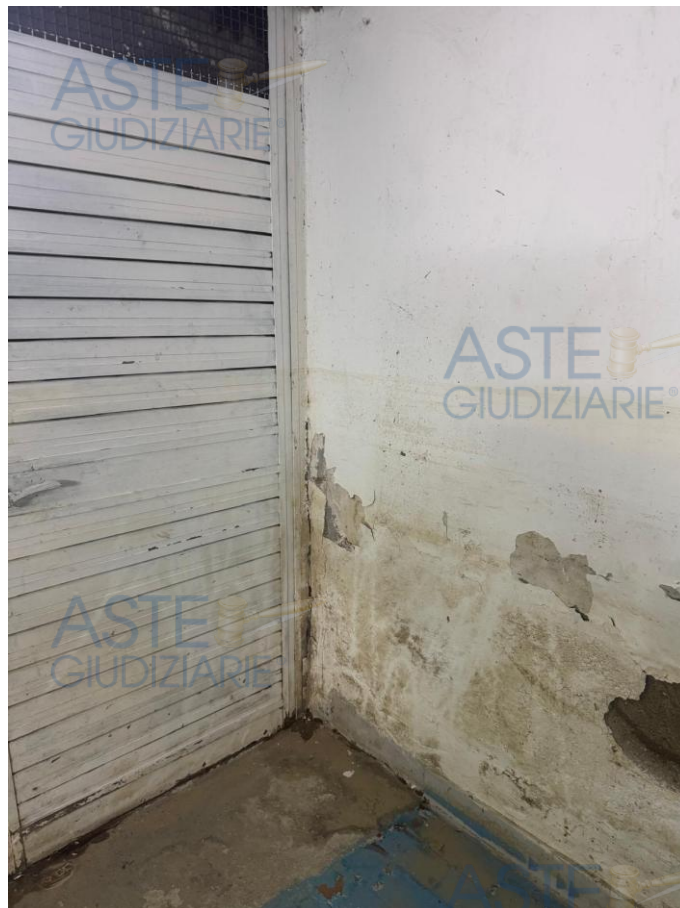
Foto locale livello raggiunto dall'acqua piovana
