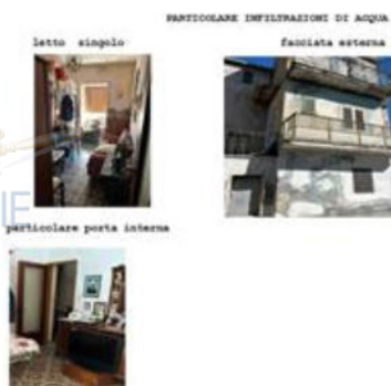
particolare infiltrazione unità immobiliare
