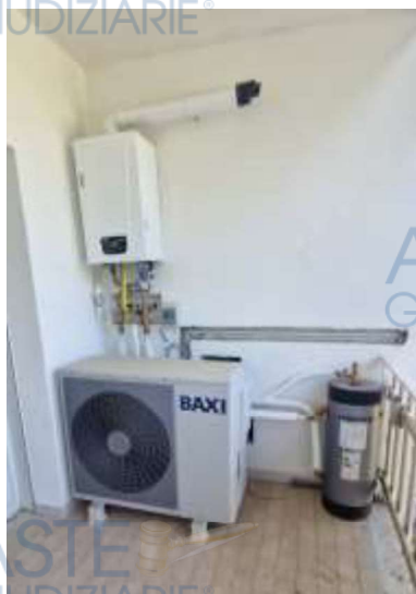
Sistema ibrido caldaia-pompadi calore
