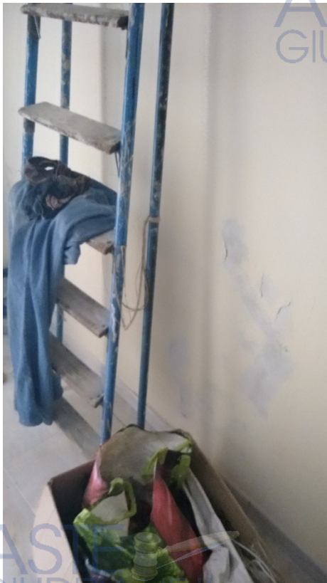
Umidità sui muri al piano terra
