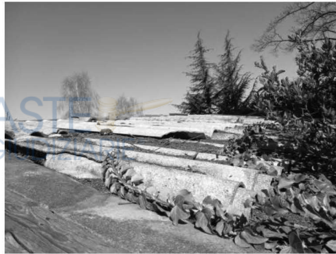
Condizioni della copertura del basso fabbricato abusivo
