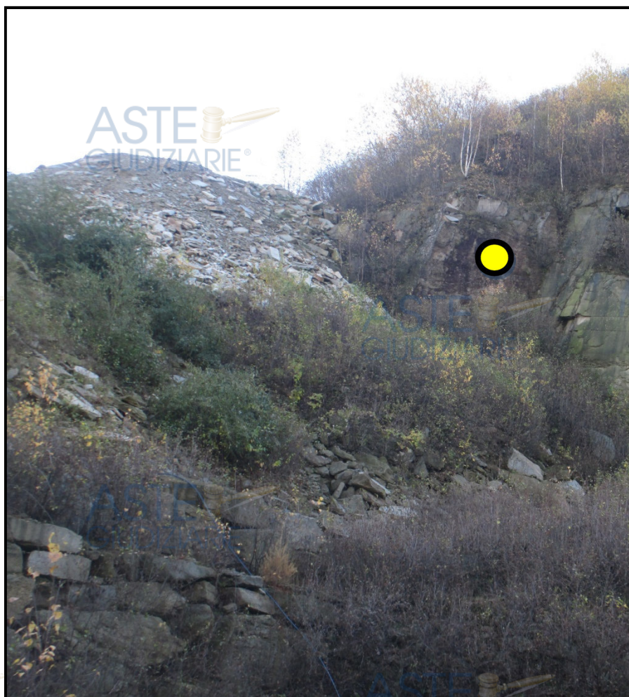
FOTO 7 (14/11/2018): Vista dal basso del settore di valle della cava “Ciafalco – Lotti n. 17-18-19”, caratterizzato dalla presenza di un ingente accumulo detritico, localmente sostenuto alla base da un muro in blocchi lapidei, frutto della passata attività estrattiva che ricopre quasi totalmente il vecchio cantiere inferiore; attualmente, di tale cantiere, è visibile solamente parte del settore sommitale del fronte di scavo principale (pallino giallo). La parte basale dell’accumulo detritico mostra già un buon grado di rivegetazione.
