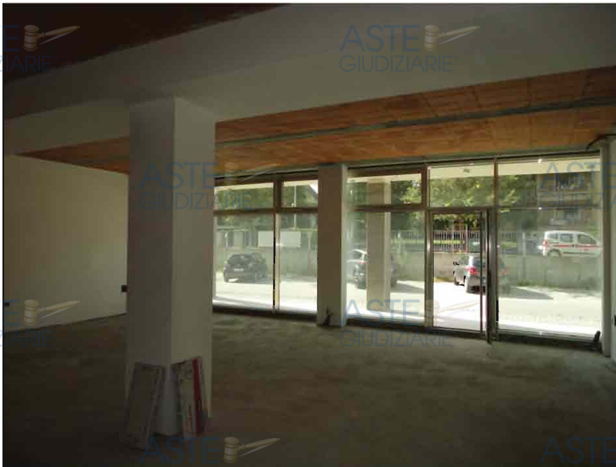
Residenza Belvedere – interno negozio
