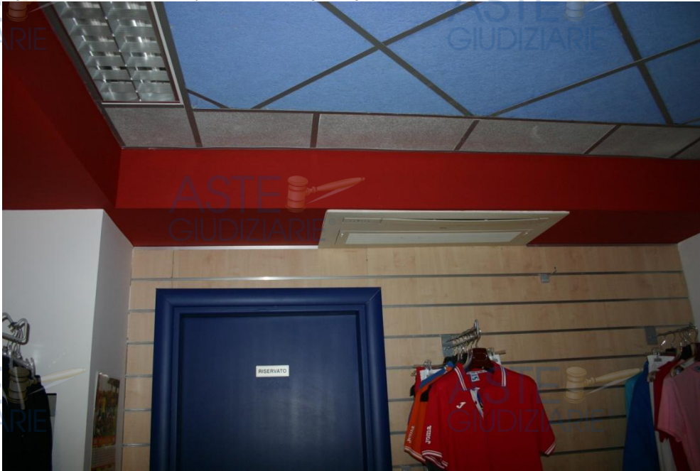
Foto 4 lotto unico fg. 90 part. 528 Via degli Ulivi 3 NEGOZIO – impianto di condizionamento Caltanissetta
