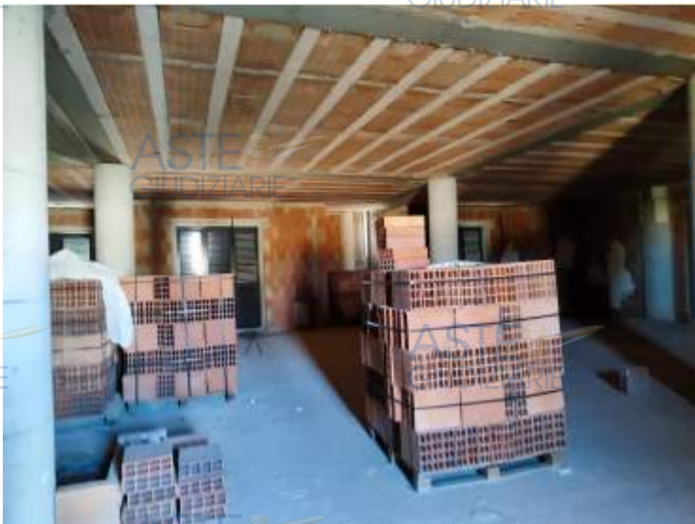
Pancali con sopra i laterizi per le tramezzature non realizzate.
