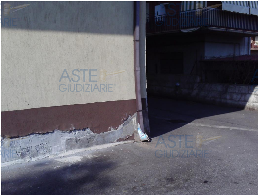
Particolare delle parti degradate dell'edificio
