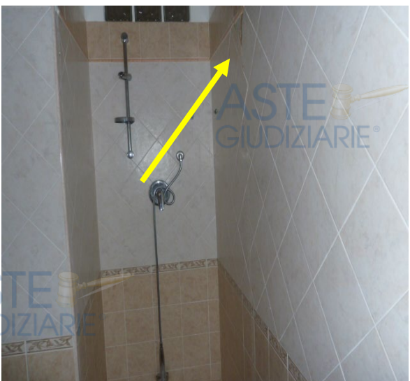
Foto n. 14 Bagno con lesioni
