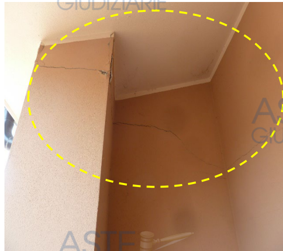
Foto n. 27 lesione prospiciente bagno piano 1
