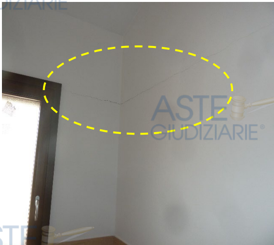
Foto n. 26 lesione bagno piano 1
