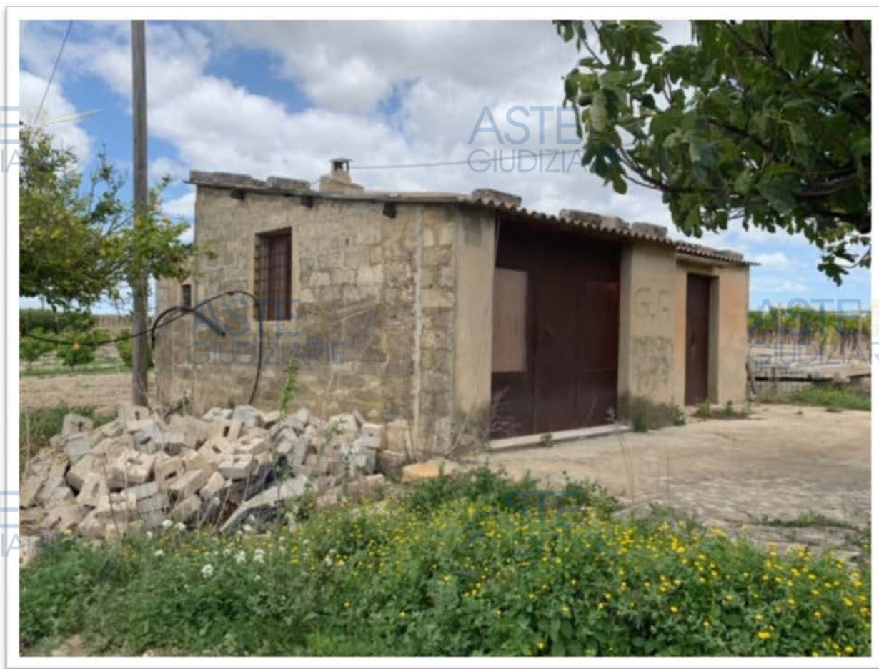
Lotto 1: part. 281 fabbricato abusivo (spigolo sud)
