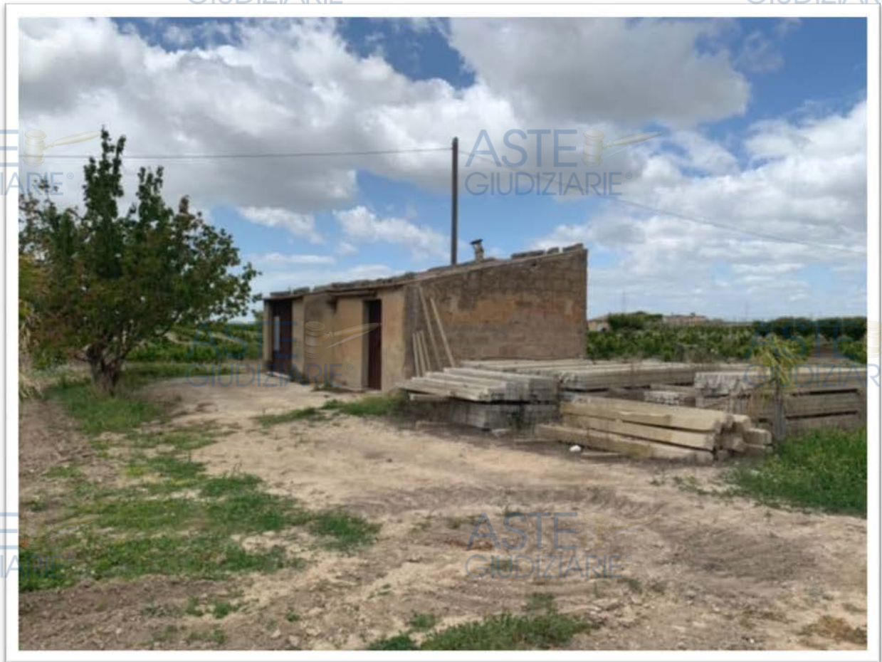
Lotto 1: part. 281 fabbricato abusivo (spigolo est)
