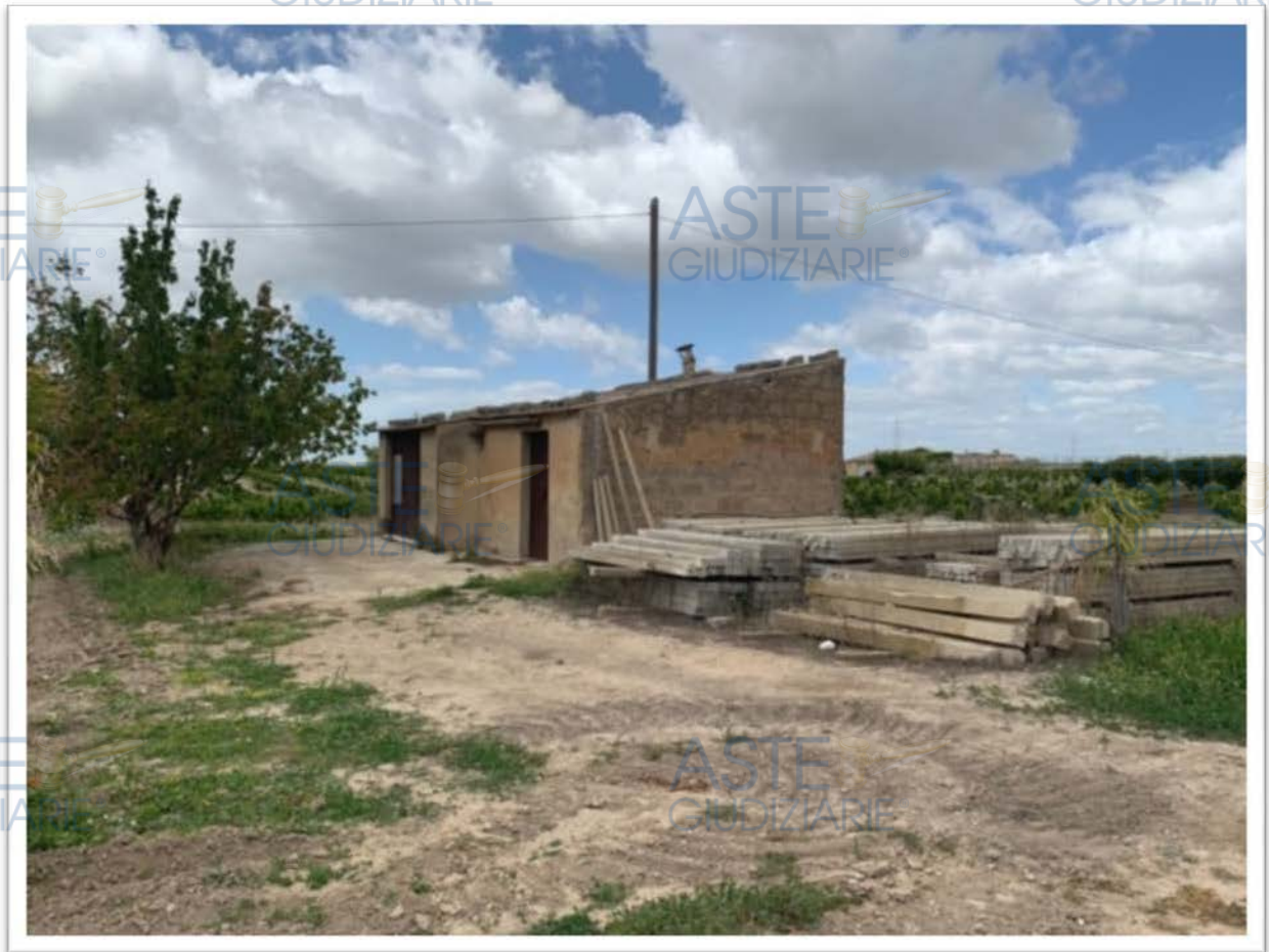
Lotto 1: part. 281 fabbricato abusivo (spigolo est)
