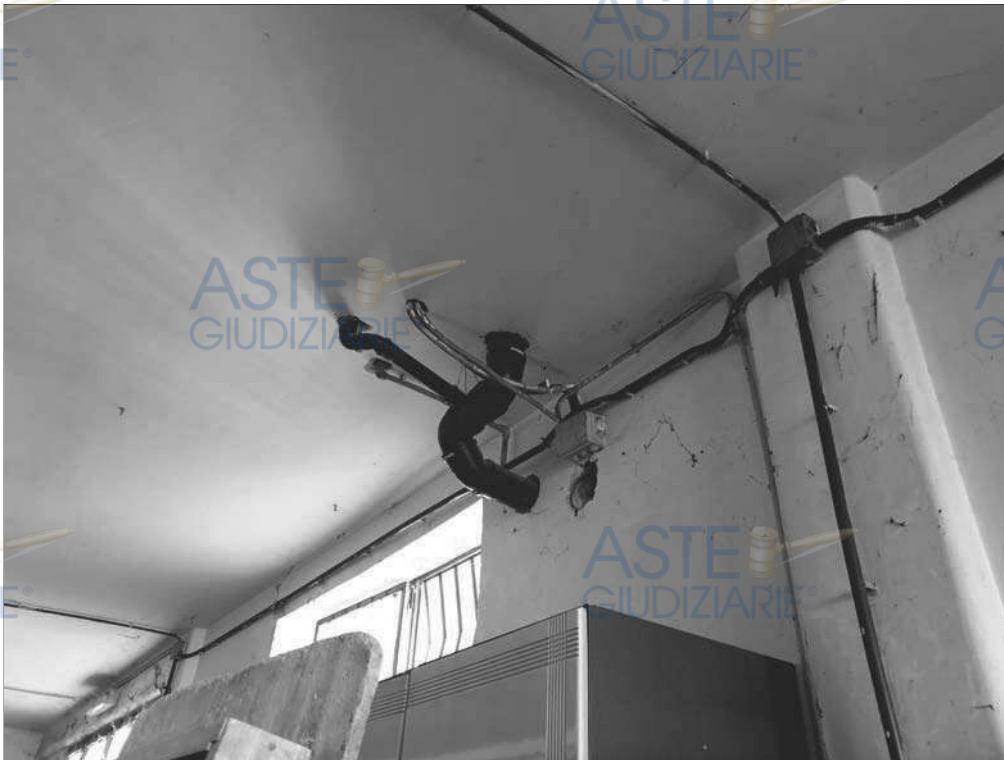
FOTO 25: TUBAZIONI A SERVIZIO DELL'UNITÀ IMMOBILIARE SOVRASTANTE
