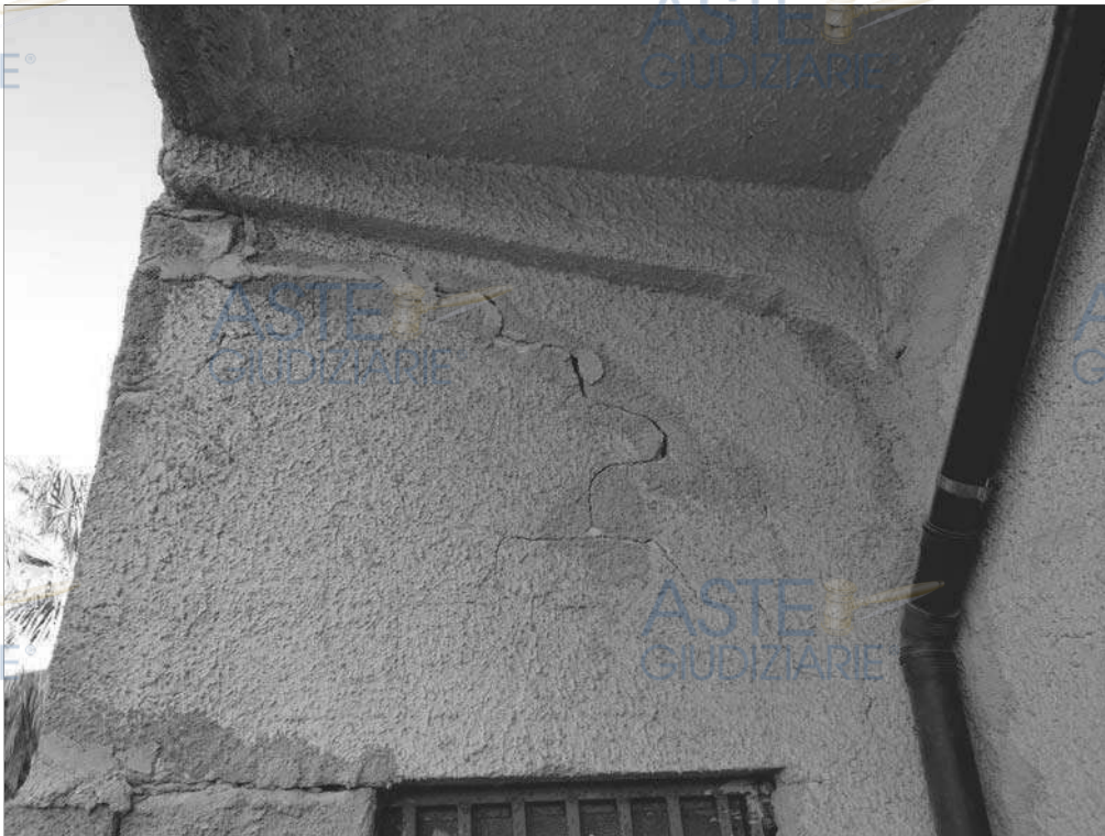
FOTO21: PARTICOLARE LESIONI DALL'ESTERNO
