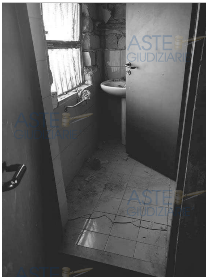
FOTO 12: SERVIZIO IGIENICO - LESIONI SUL PAVIMENTO Publicazione ufficiale ad uso esclusivo personale - è vietata ogni ripubblicazione o riproduzione a scopo commerciale - Aut. Min. Giustizia PDG 21/07/2009
