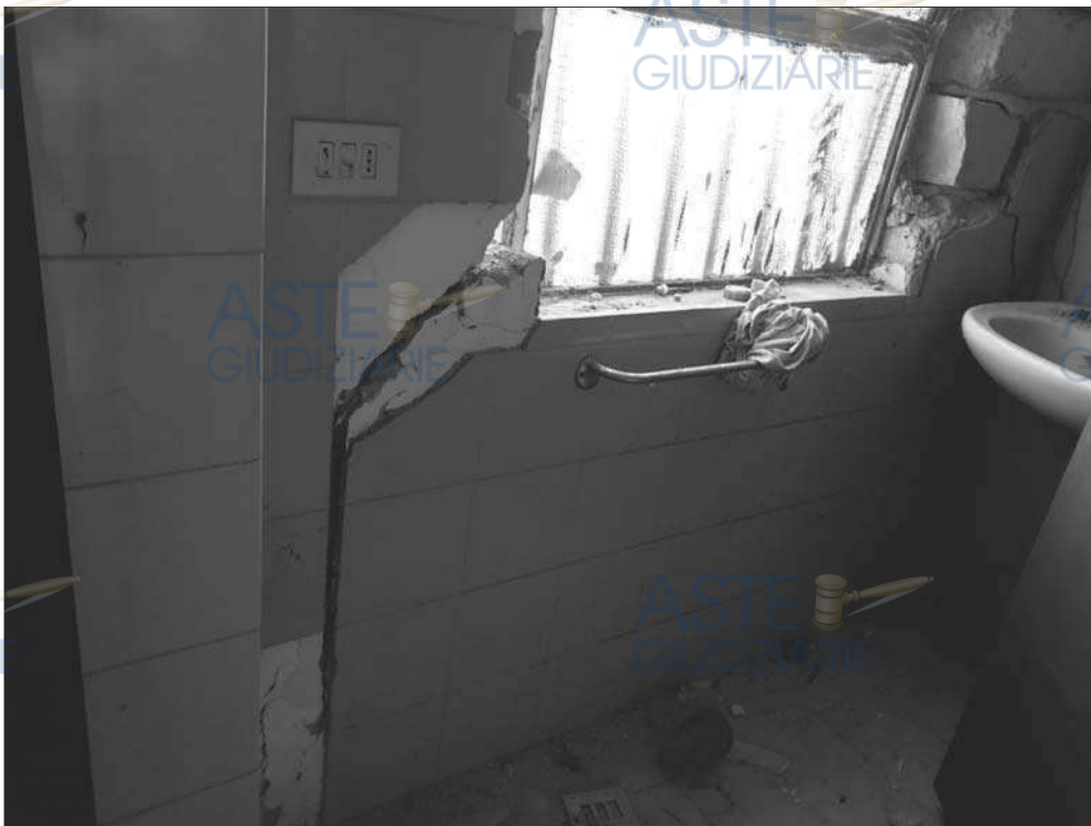
FOTO 13: SERVIZIO IGIENICO - LESIONI SULLA MURATURA DI TOMPAGNO
