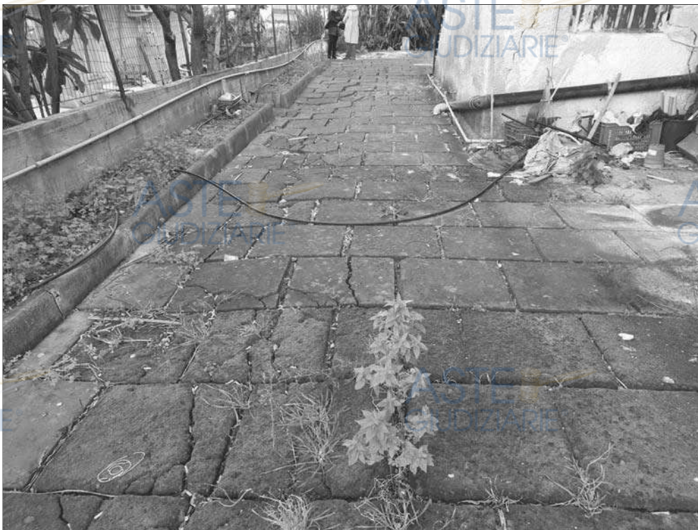
FOTO 23: SPIAZZALE - PRESENZA DI AVVALLAMENTI
