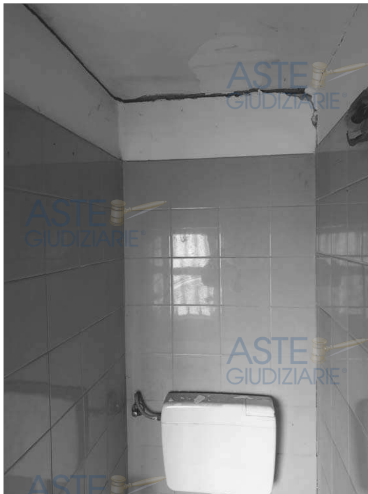
FOTO 17: W.C. - DISTACCO DELLA MURATURA DALLA SOLETTA PUNTELLATA
