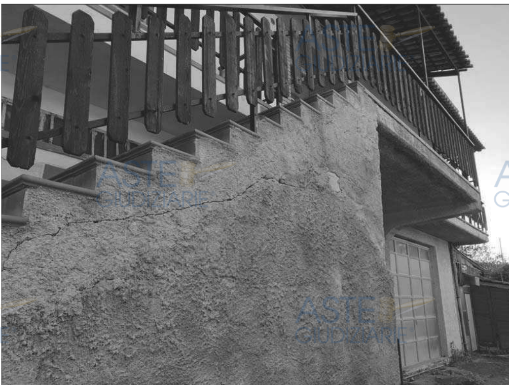
FOTO 22: PARTICOLARE LESIONI DALL'ESTERNO
