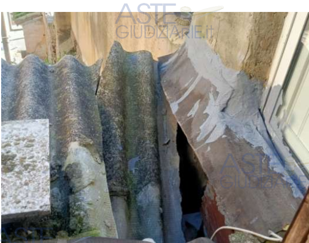
Rottura della copertura in ETERNIT, posta in corrispondenza del ripostiglio posto nel sottoscala adiacente al salone
