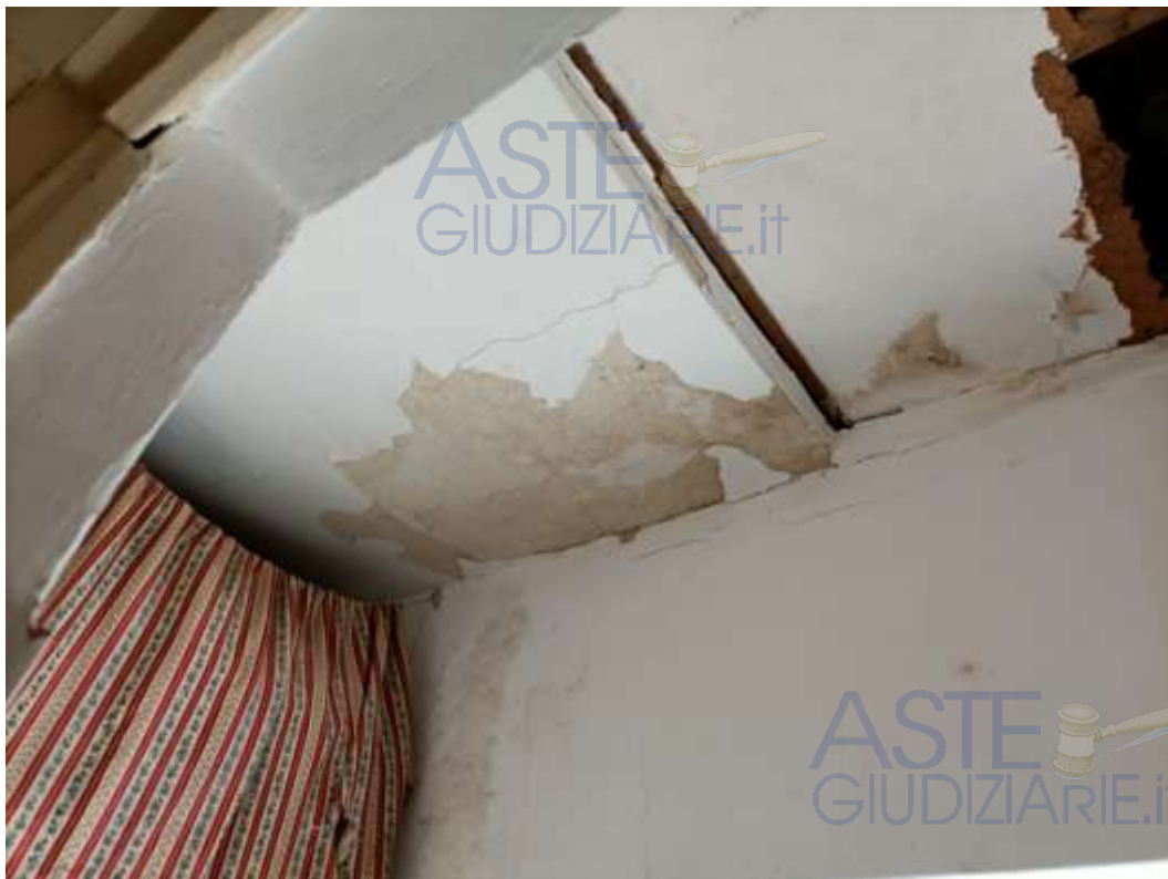
Intradosso del wc di servizio
