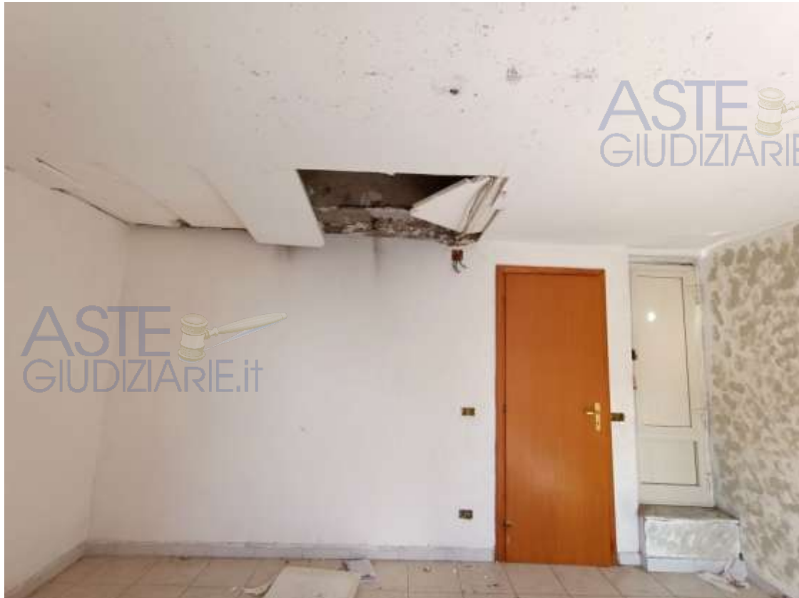
Foro nel cartongesso nella camera da letto ( vano abusivo) posta al secondo livello e tracce di condensa
