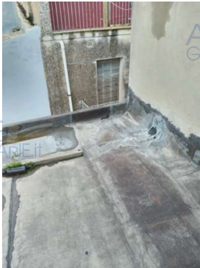
Guaina con evidenti tracce di riparazioni in corrispondenza del risvolto
