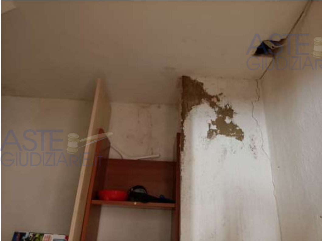
Infiltrazione presente all'interno del ripostiglio posto nel sottoscala adiacente il salone
