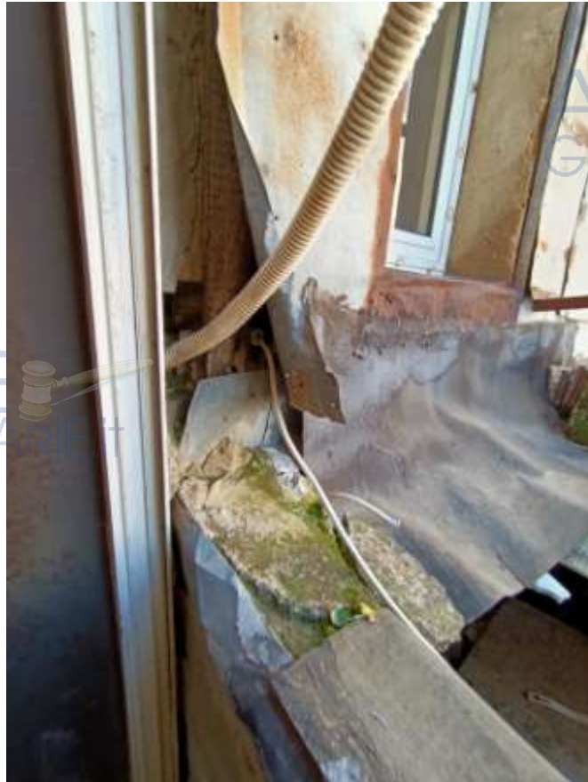
Copertura metallica non più adesa.
