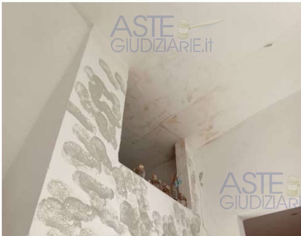
L'intradosso del ripostiglio del primo livello presenta macchie di umidità e un rigonfiamento
