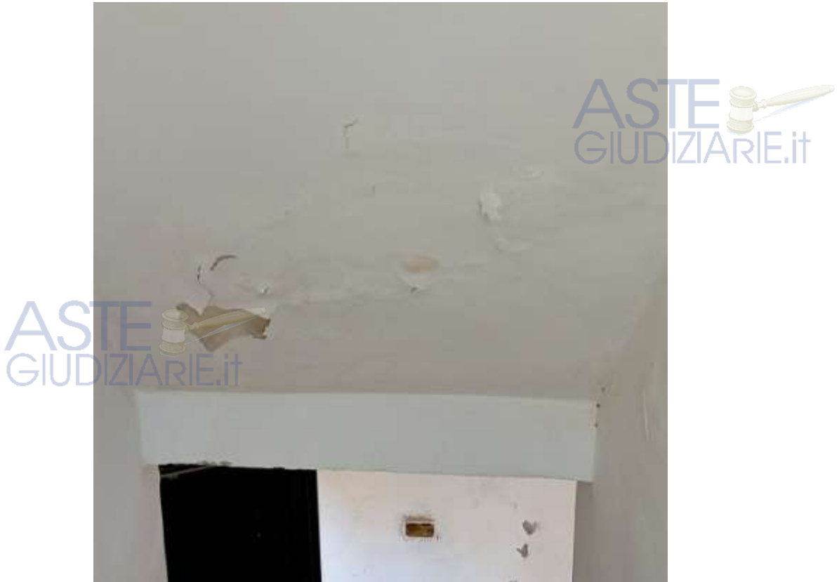
Infiltrazione nel vano scala in corrispondenza del doppio servizio del primo livello
