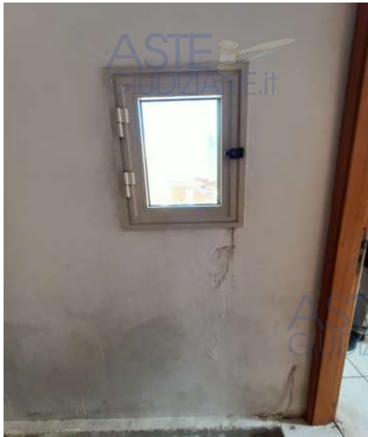
Finestrella posta nel pianerottolo di arrivo della rampa di scale presenta “baffi” e rigonfiamenti da infiltrazione da acqua meteorica e lo stacco di porzioni della pittura.
