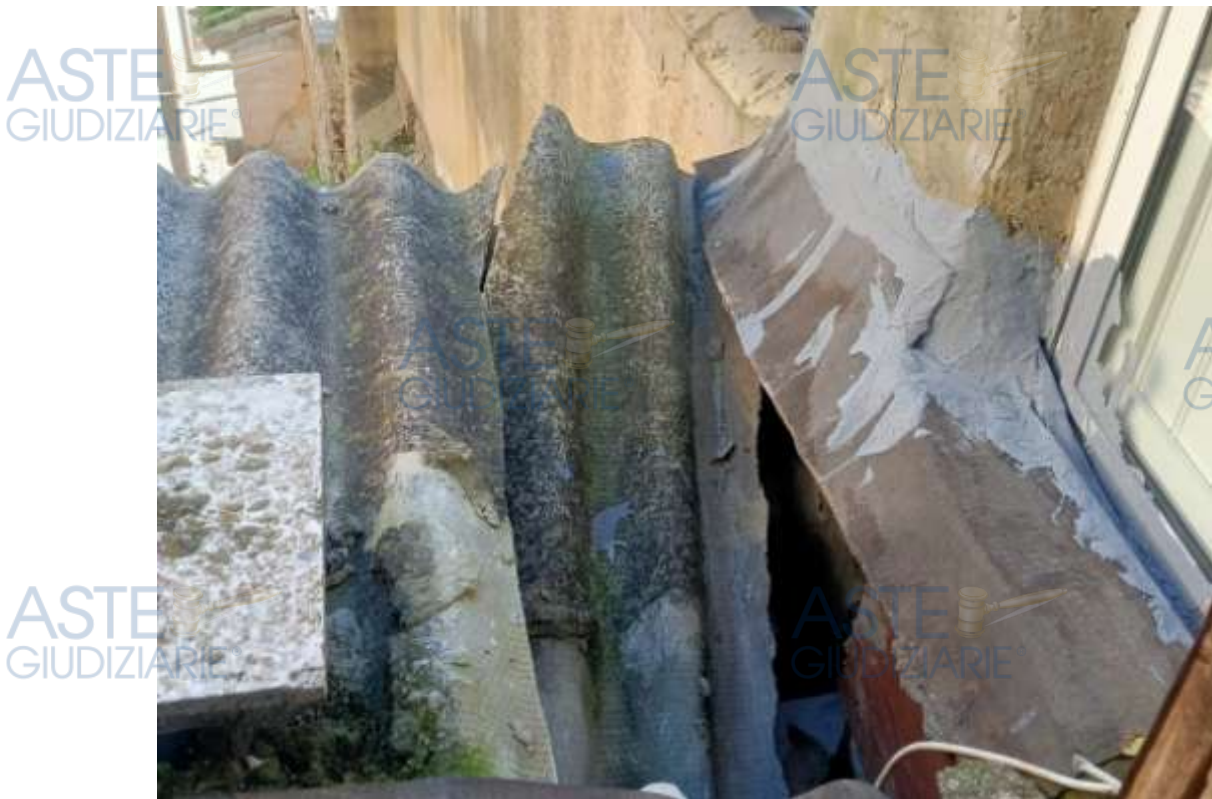
Rottura della copertura in ETERNIT, posta in corrispondenza del ripostiglio posto nel sottoscala adiacente al salone
