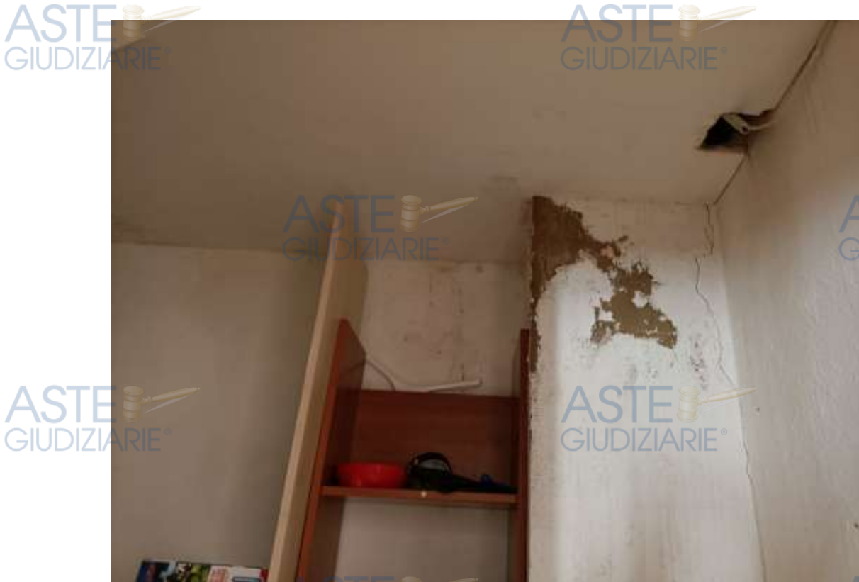
Infiltrazione presente all'interno del ripostiglio posto nel sottoscala adiacente il salone
