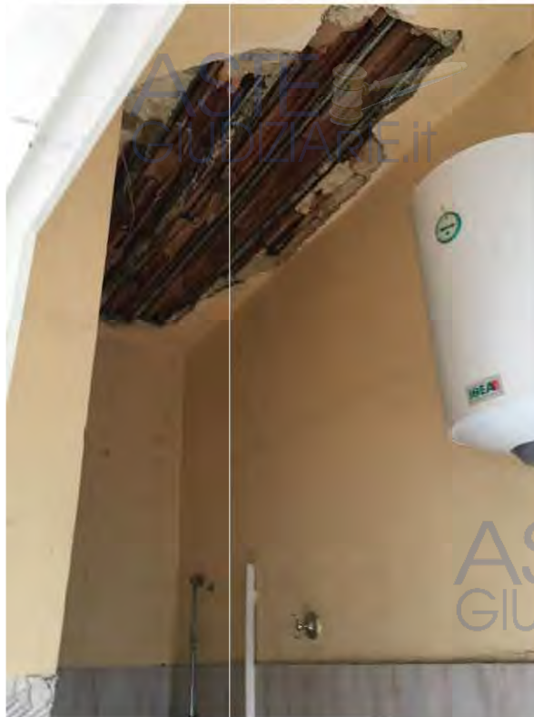
Foto 8 – Unità immobiliare identificata al Catasto al fg 141, part. 501, sub 2 - Piano Primo Intradosso del solaio di copertura del Bagno
