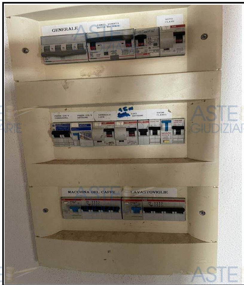
Foto n°9 - Particolare quadro elettrico
