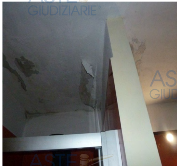
Foto n. 21 segni di infiltrazioni esterne
