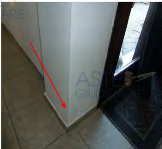
Foto n. 26 segni di umidità
