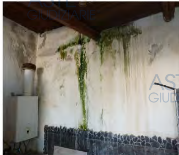
Foto n. 27 segni di infiltrazioni esterne
