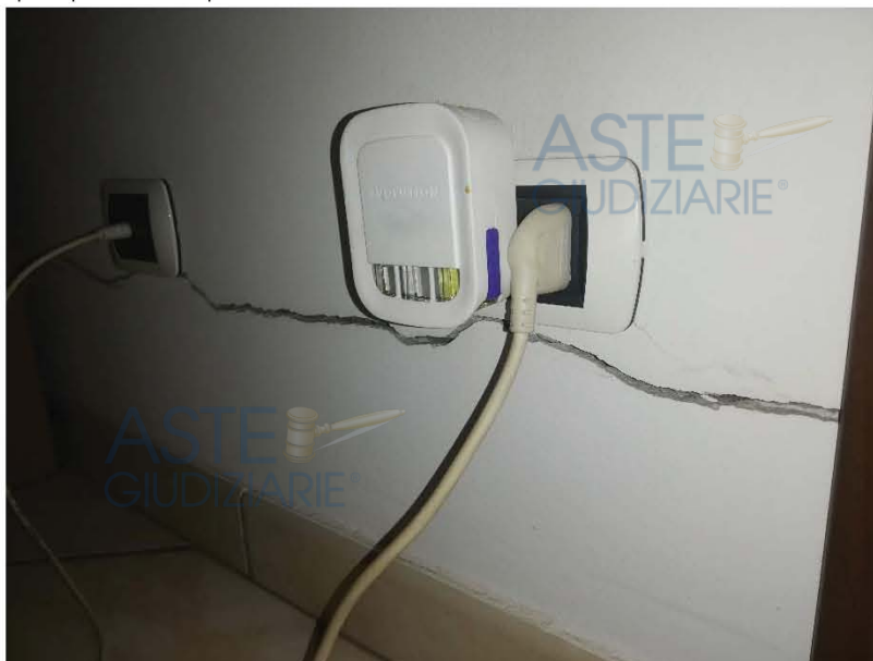
Foto 6) Lesione di tipo "passante" presente in un tratto del tramezzo tra due camere da letto
