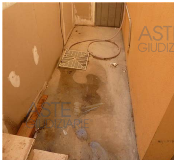
Foto n. 20 Piano seminterrato e pompa sommersa
