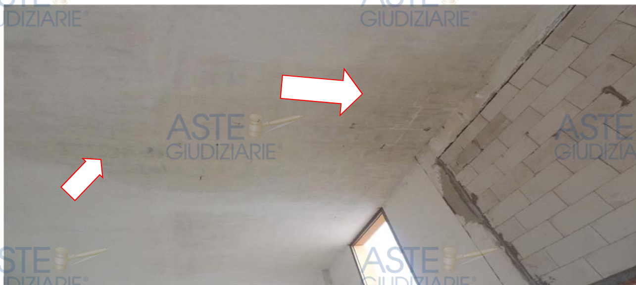
Foto n. 33 Evidenti segni di umidità
