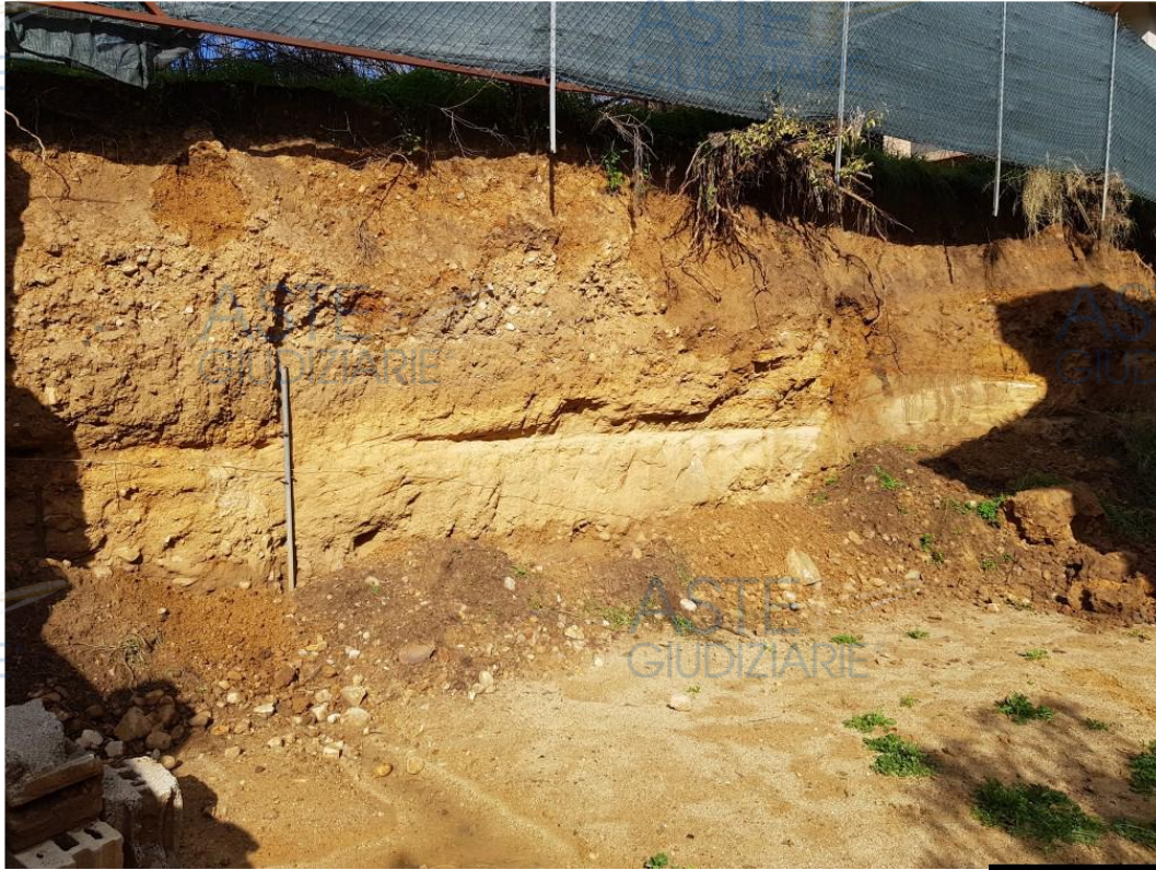
Altro particolare dello stato del terreno nel tratto di confine [redacted] in data 18/11/2021
