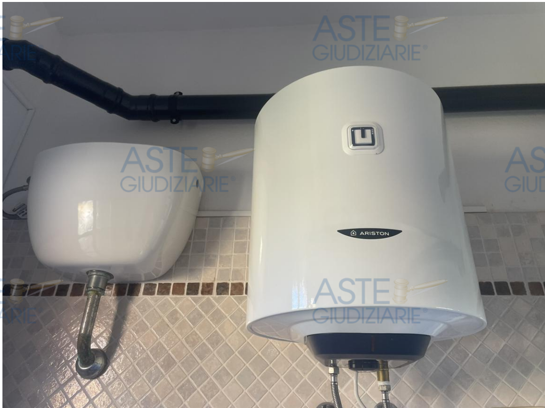
Dettaglio dello scaldabagno
