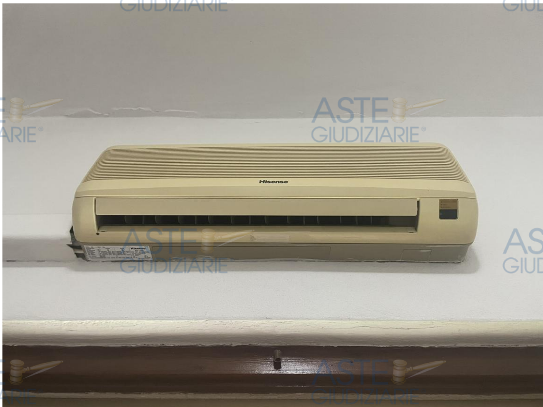
Dettaglio della pompa di calore delle camere
