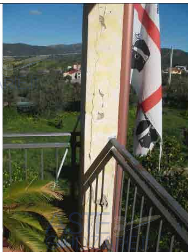
Foto n° 20 - DETTAGLIO STRUTTURA DANNEGIATA
